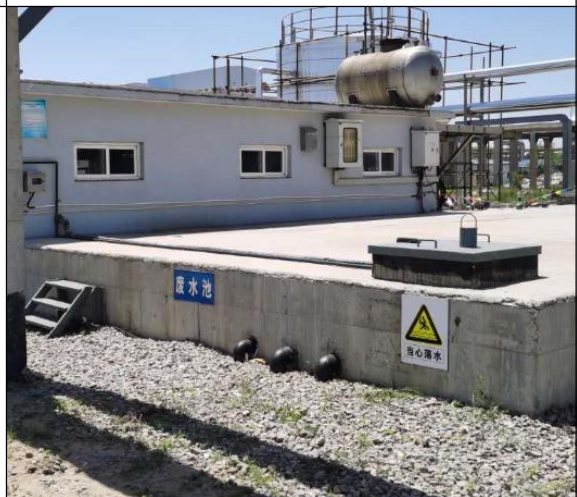
废水池及废水排口
