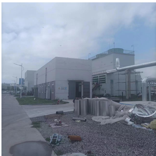
机力通风冷却塔及循环水泵房
