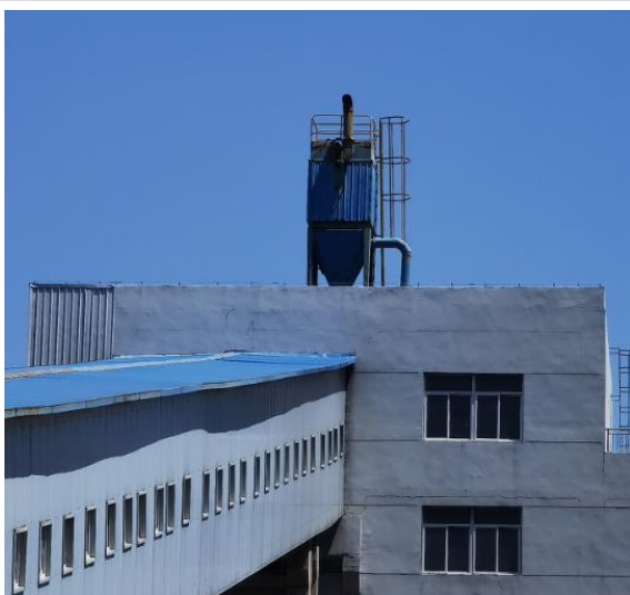
输煤系统除尘器
