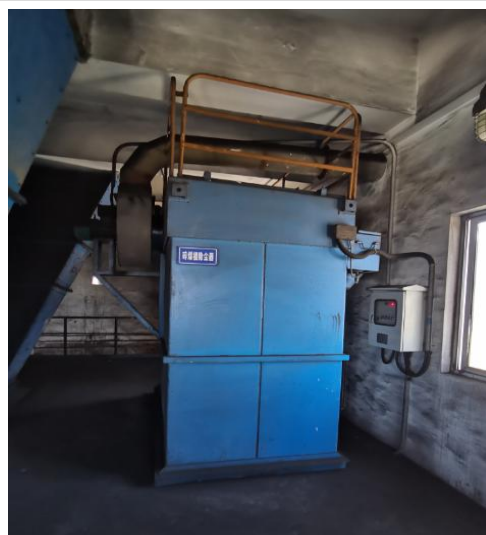
输煤系统除尘器
