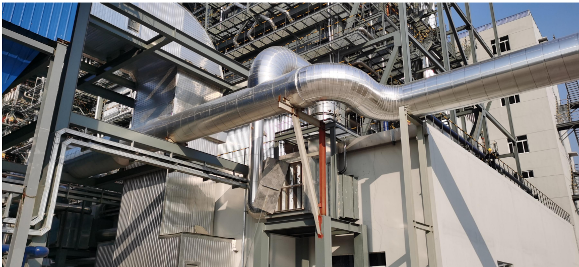
氨基酸公司无组织废气输送管线
