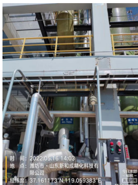
盐酸回收塔和碱洗塔
